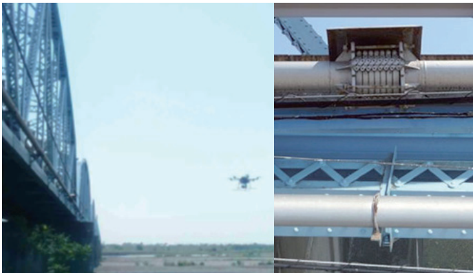
道路橋構添架ガス導管 (御協力: 中部ガス株式会社殿)
